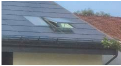
Dachflächenfenster mit Solaranlagen
